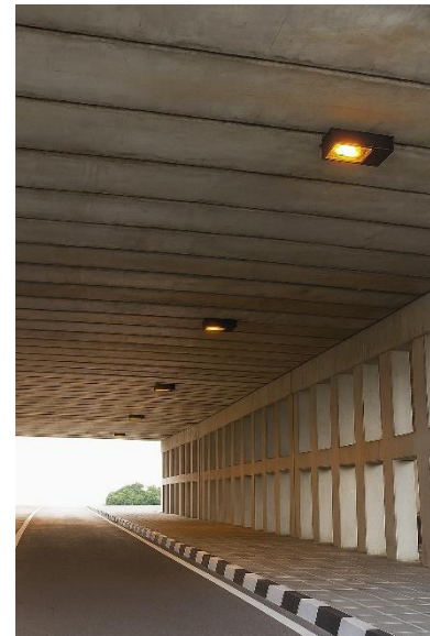
โคมไฟติดตั้งสะพาน
